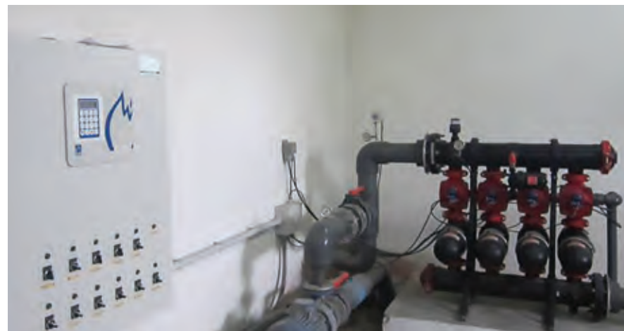
Unidade de controle central para programar o tempo e fluxo de irrigação
