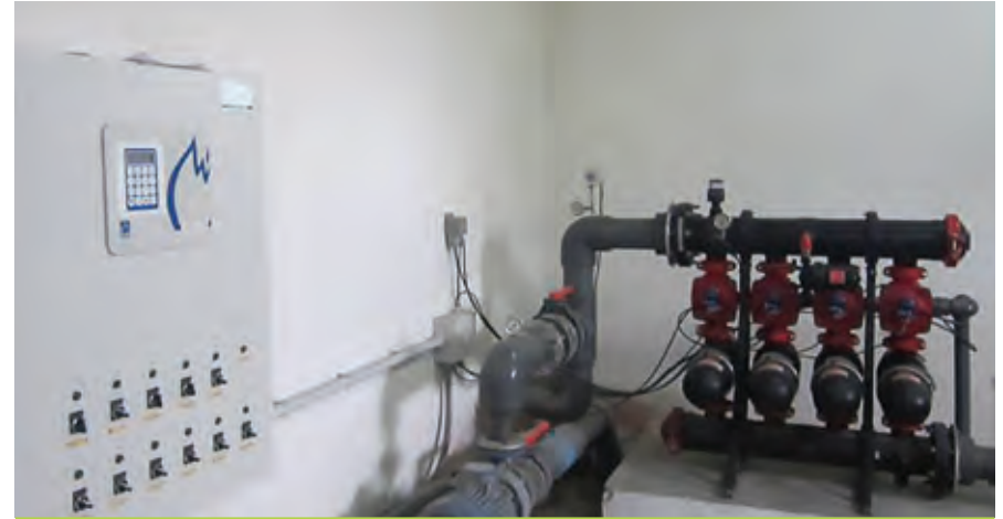
La unidad de control central debe programar el tiempo y caudal de riego
