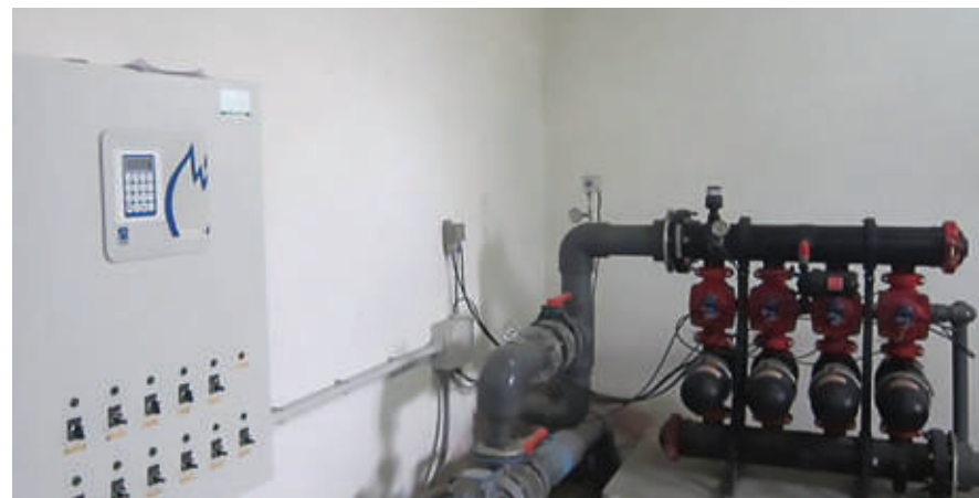
Unité de contrôle de l'irrigation, pour la programmation du temps d'irrigation et du débit
