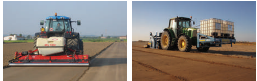
Una vista de la superficie del suelo después de la pasada de un rodillo compactador
