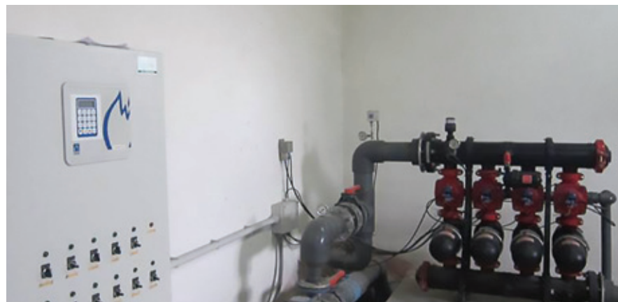
Κεντρική μονάδα ελέγχου για τον προγραμματισμό του χρόνου και της ροής άρδευσης
